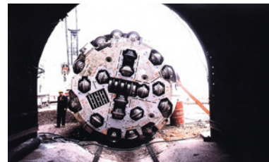
GALLERIA IDRICA DI ADDUZIONE "LOS ROSALES" COLOMBIA
